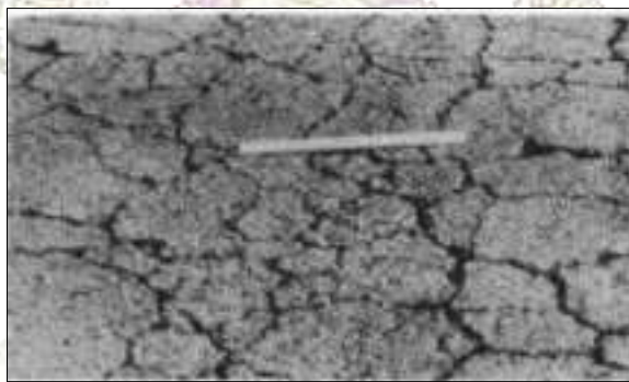
Gambar 2. 1 Retak Kulit Buaya ( Aligator Cracking )
