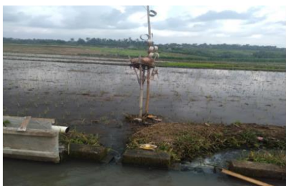
Foto 8. Bagunan bagi yang membagi air ke setiap lahan sawah anggota subak (Foto :Sukanteri)
