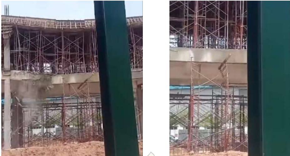
Gambar 2. 1 Contoh bangunan gedung yang runtuh (Sumber: @civilengineeringdiscoveries, 2024)
